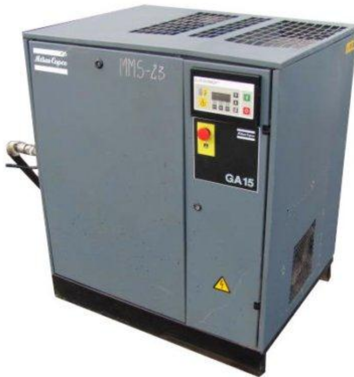
Figure(I.9) : compresseur à vis Atlas COPCO GA15
