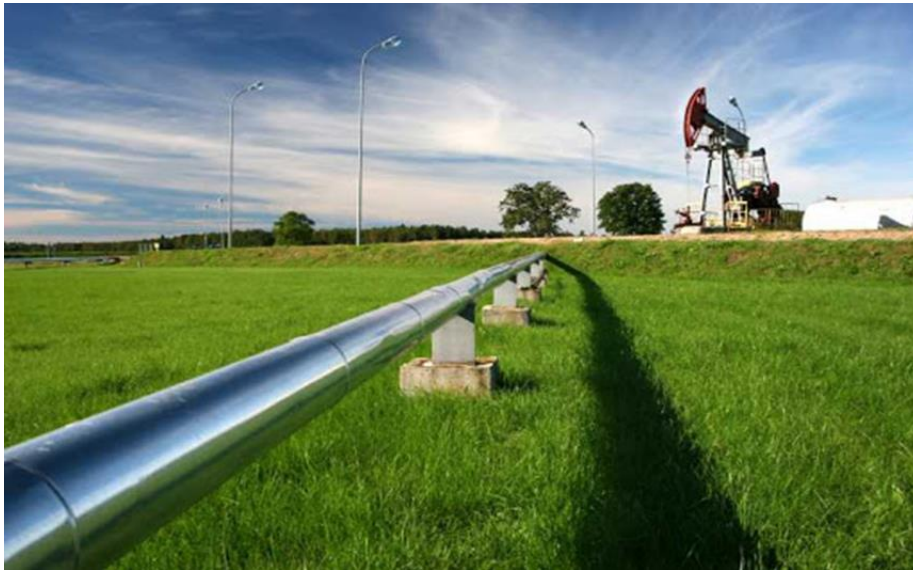
Figure II. 2 Pipeline dans l'environnement [30].
