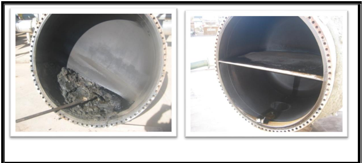
Figure III.18.les dépôts dans l'échangeur
