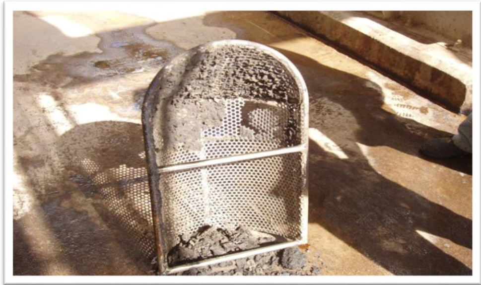
Figure III.3. Dépôt de sel sur Strainer
