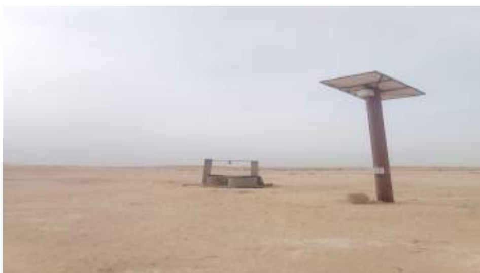
Figure n° 12 : puits équipé en énergie solaire
