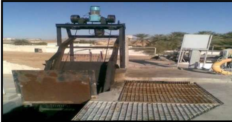
Figure 26 un dégrilleur mécanique.
