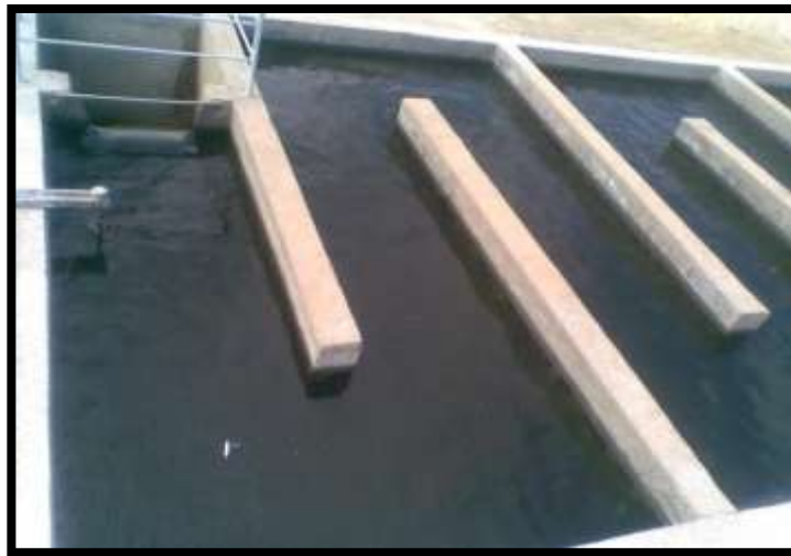
Figure 30 Bassin de chloration
