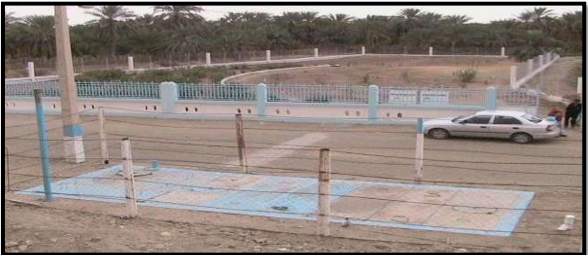
Figure 16 Station d'Épuration des Eaux Usées Waste water Garden, Vieux Ksar de Témacine
