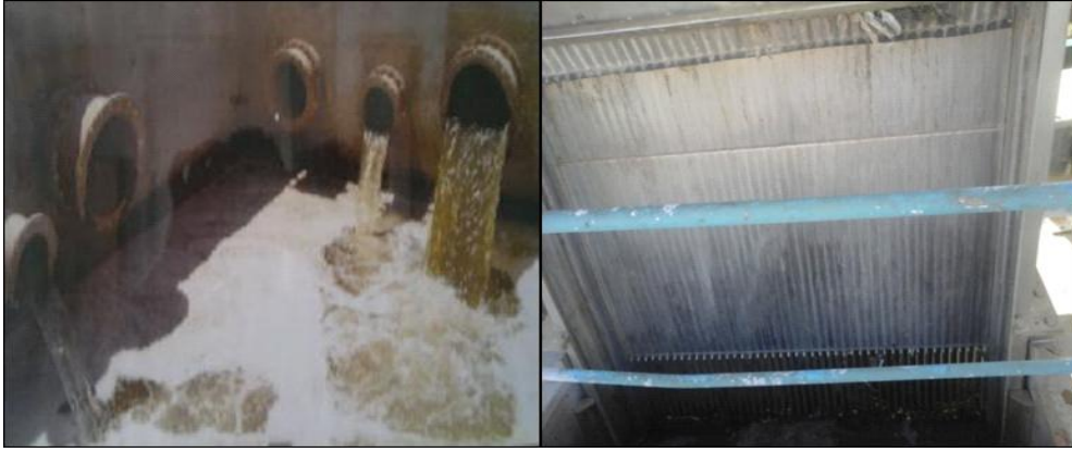
Photo 1 : bassin de dégazage et le dégrillage.
