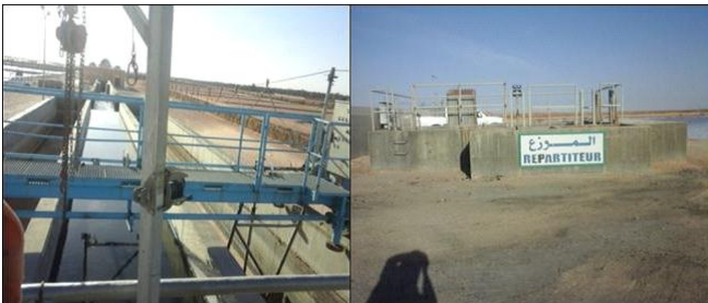
Photo2 : Dessablage et ouvrage de répartition
