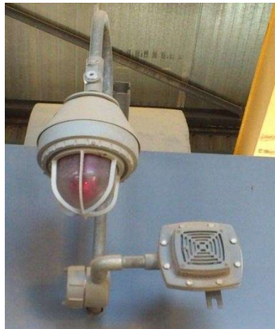
Figure 2.22 : Lampe et sirène (zone enceinte turbine)
