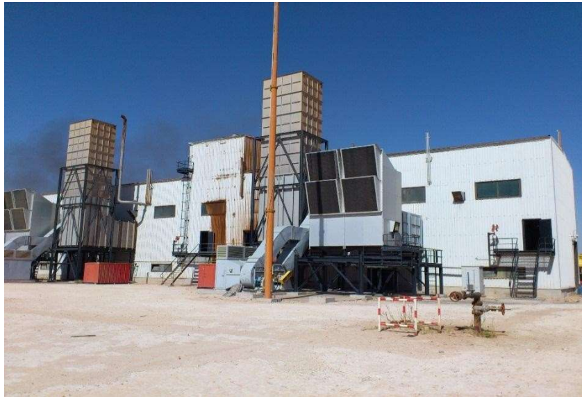
Figure 2.2 : vue de l'extérieur de la station de compression SC3
