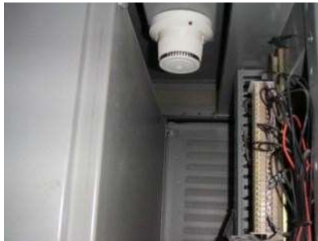
Figure 2.19 : Détecteur de fumée installée dans une armoire de la sous-station électrique.
