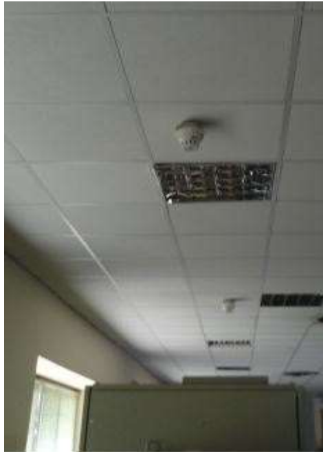
Figure 2.17 : Détecteur de fumée sur le plafond de la salle de contrôle
