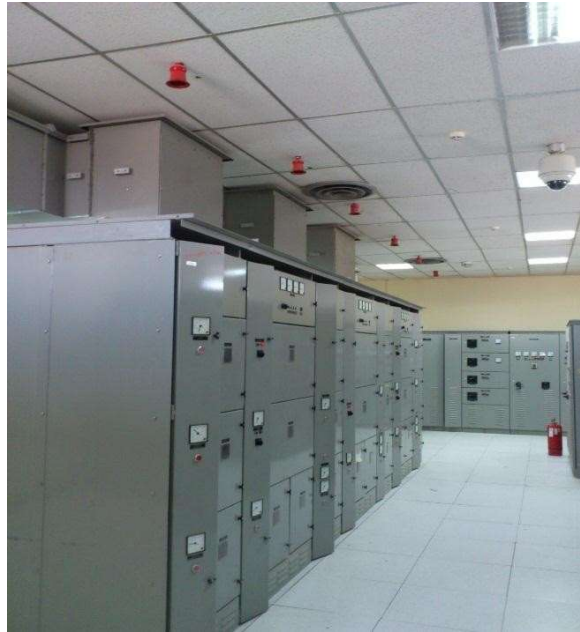
Figure 2.18 : Les armoires de la sous-station électrique.
