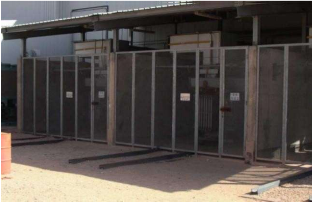
Figure 2.20 : Les 3 transformateurs électriques (TR901, TR902, TR903)
