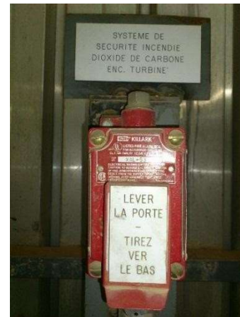
Figure 2.21 : Bouton de décharge manuelle salle machine
