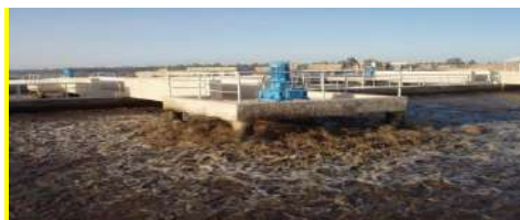
Photo 16 : Le bassin d'aération
