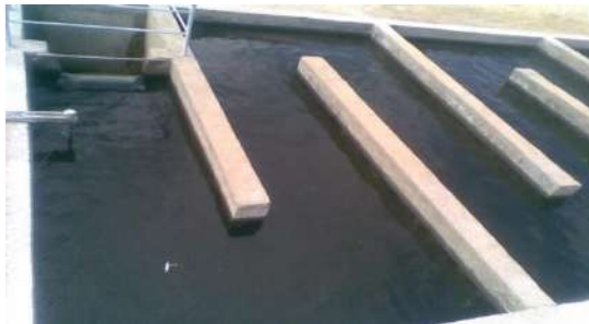
Photo 18 : Bassin de chloration
