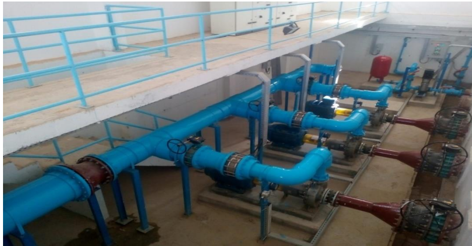
Figure 5.6 : Station de pompage d'eau traitée.
