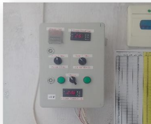
Photo N°14 : Contrôle à distance dans le bâtiment
