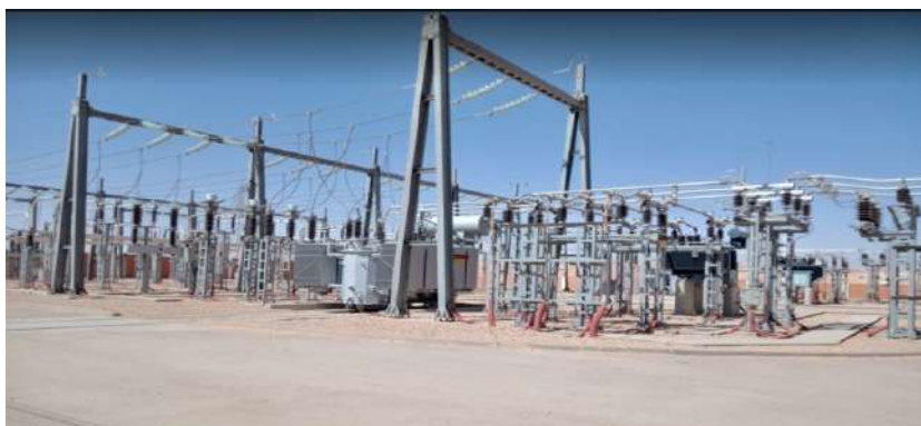
FIGURE II.9 – Le poste haute tension (PHT) de tramway de Ouargla.[22]
