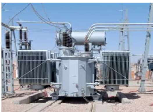
FIGURE II.11 – Transformateur de puissance 60 /30 KV-13MVA. [22]
