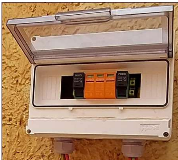
Figure III.17: Parafoudre et porte fusible de protection
