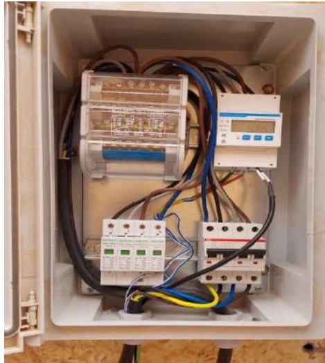
Figure III.16: Armoire des équipements de protection
