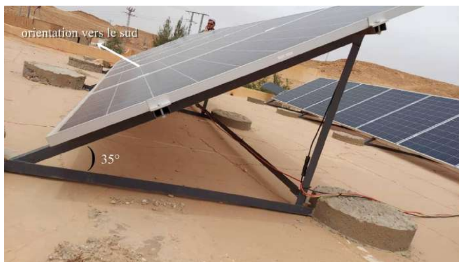
Figure III.5: Positionnement des panneaux PV
