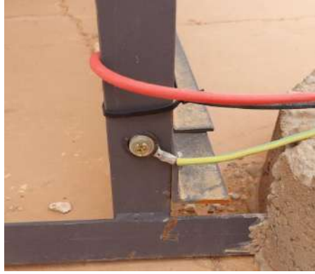
Figure III.18: mise à la terre de structure de module
