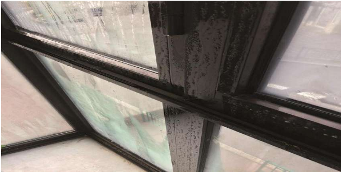
Figure 8: Exemple de condensation de menuiserie © 2017-AQC-Erwan BIDAN
