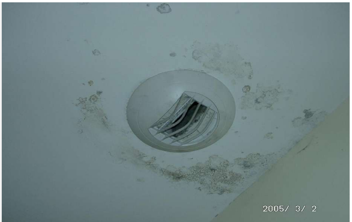
Figure 13 : Défaut d'entretien de la VMC – insuffisance de ventilation – défaut
