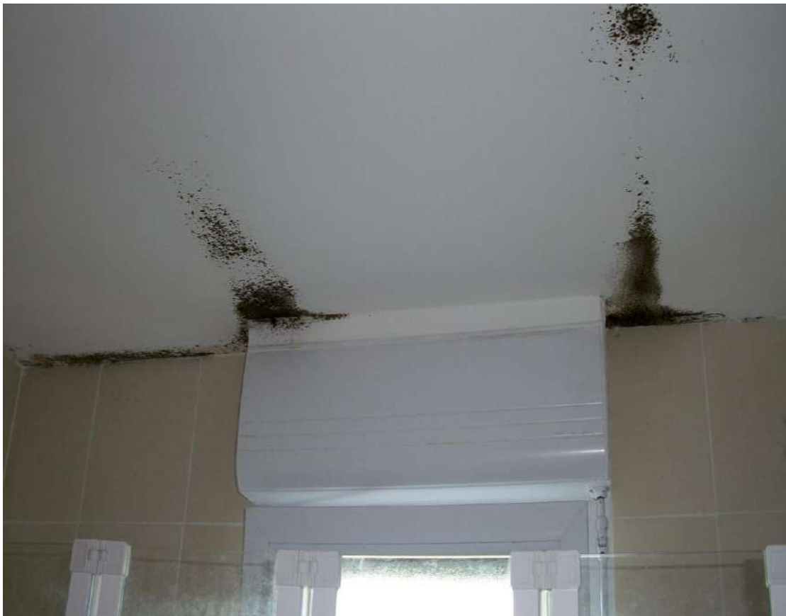
Figure 11 : Présence d'un pont thermique en plancher haut – insuffisance de ventilation.
