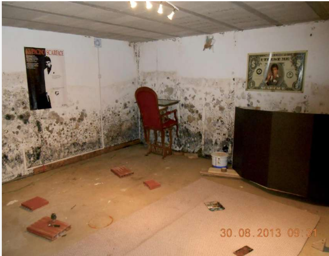
Figure12: Air ambiant vicié et saturé en vapeur d'eau – insuffisance ou absence de ventilation...
