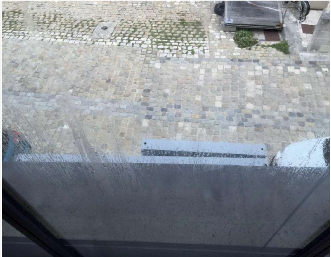
Figure 14 : Défaut d'isolation du montant de la menuiserie – défaut d'étanchéité du joint.
