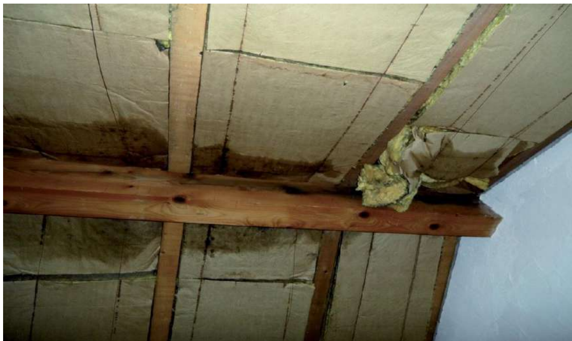
Figure 9 : Exemple de condensation au travers de la paroi (photos prises après démontage des lambris). © 2015-AQC – Mathieu CORTAL (absence de pare vapeur intérieur).
