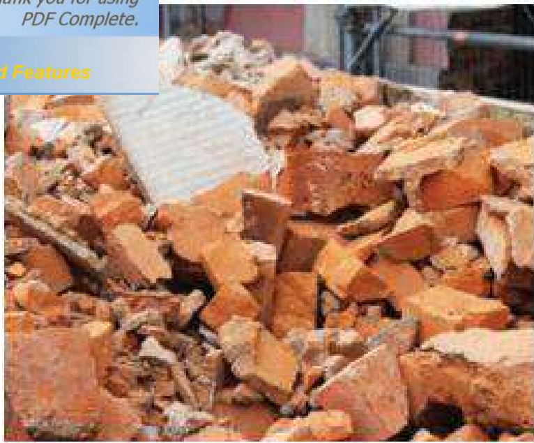
Figure 14: déchets de béton [24]
