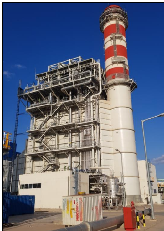
Figure 2.15. Photo de la chaudière de récupération de la centrale d'Ain Arnat
