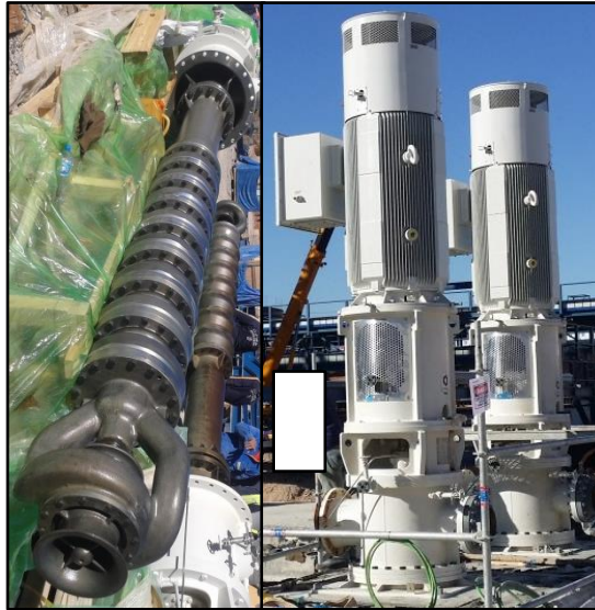
Figure 2.25. Ejecteur d'air de la centrale d'Ain Arnat
