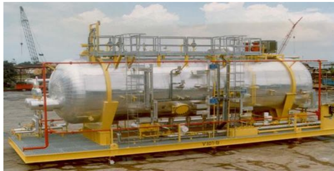
Figure I.2 : Vue extérieure d'un dessaleur sur skid sortie usine
