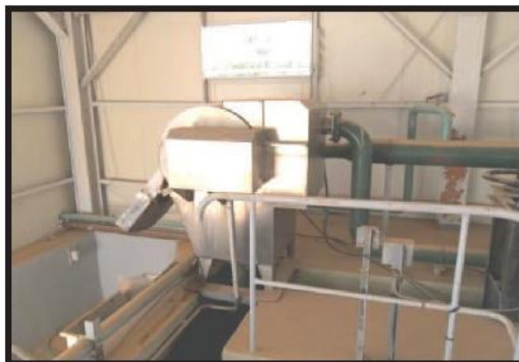
Figure (I. 1) : Dégrilleur
