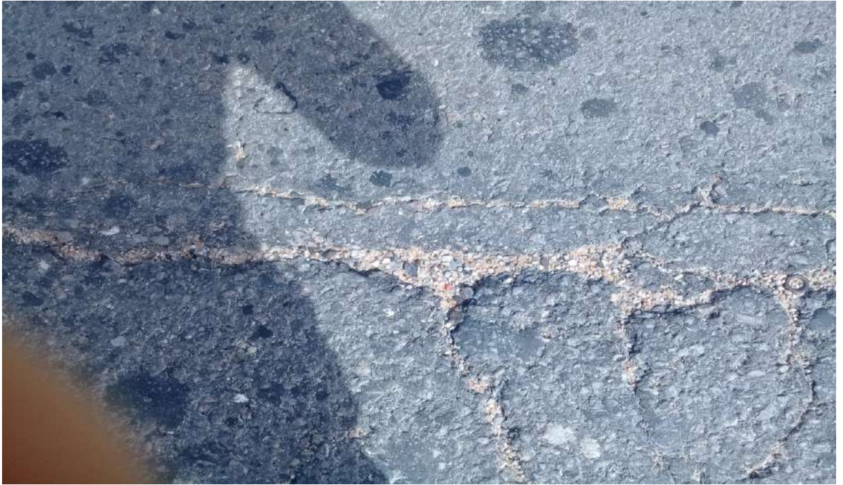
Figure 2 photographie de fissures transversales
