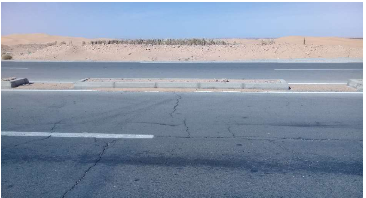
Figure AI. 5 photographie de fissures transversales
