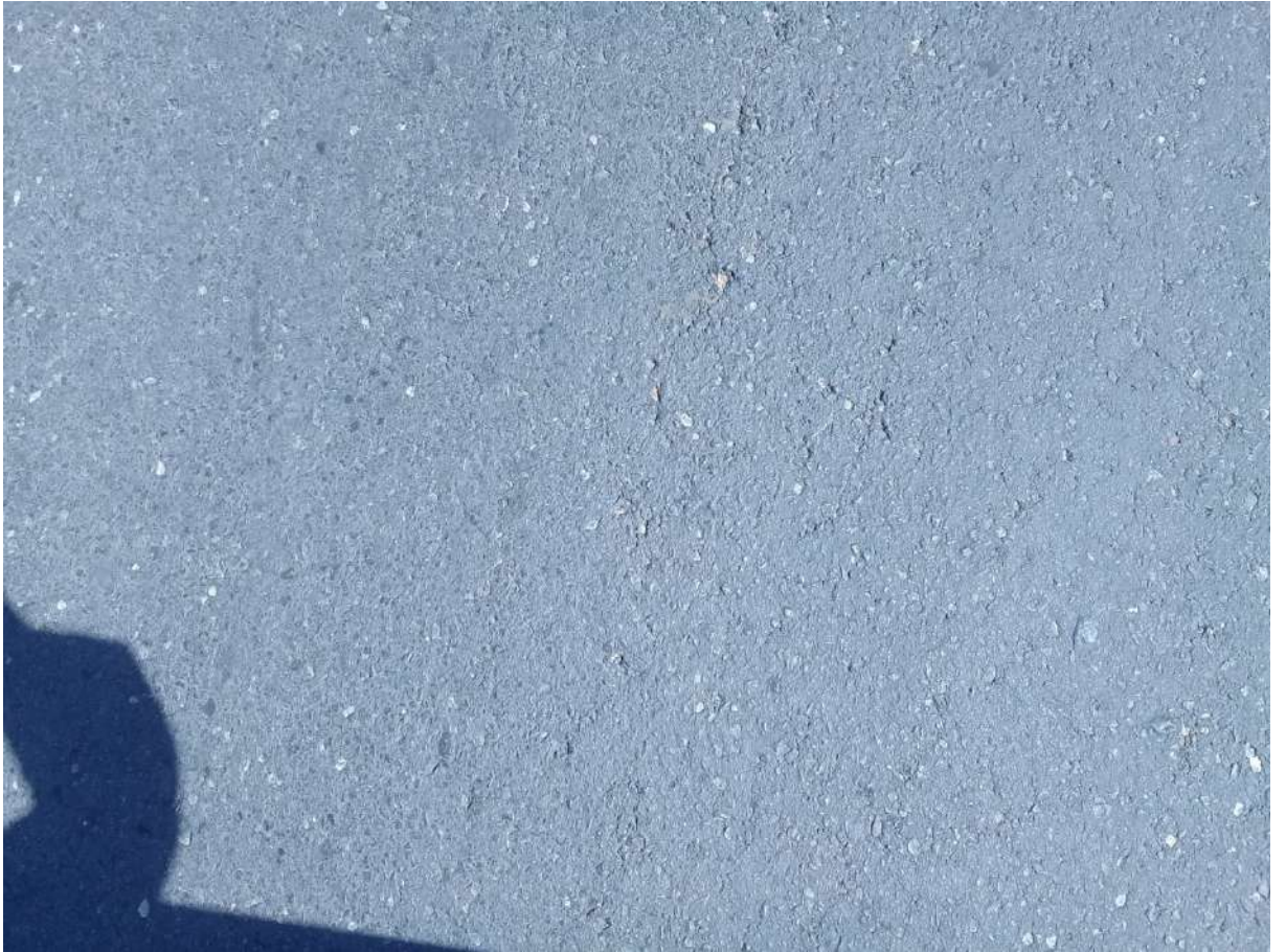
Figure AI. 10 photographie bon béton bitumineux de la chaussée des arrachements
