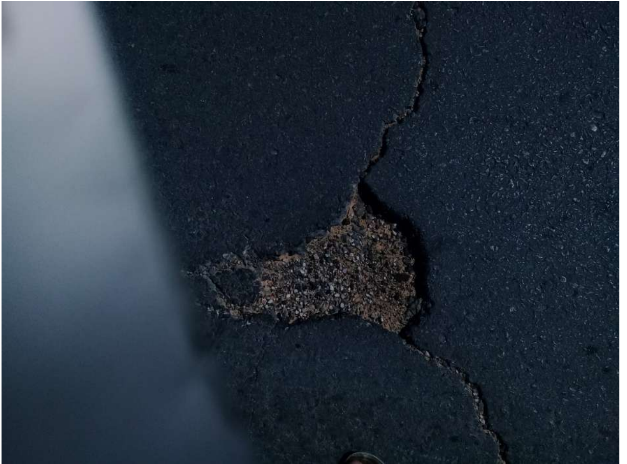
Figure 8 photographie des arrachements
