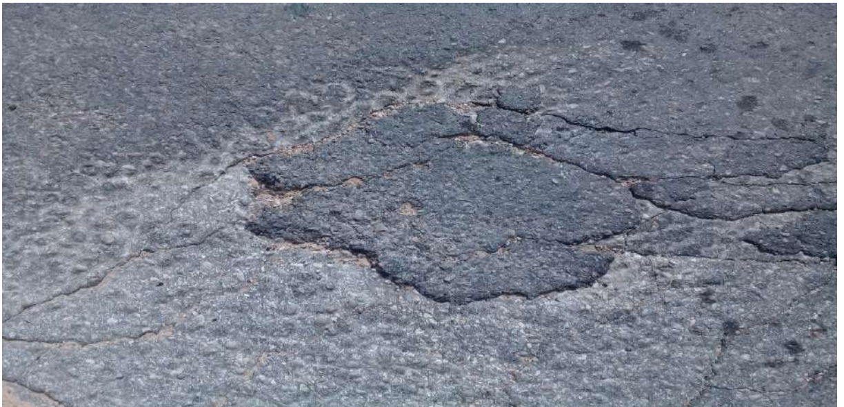
Figure 3 photographie de dégradation
