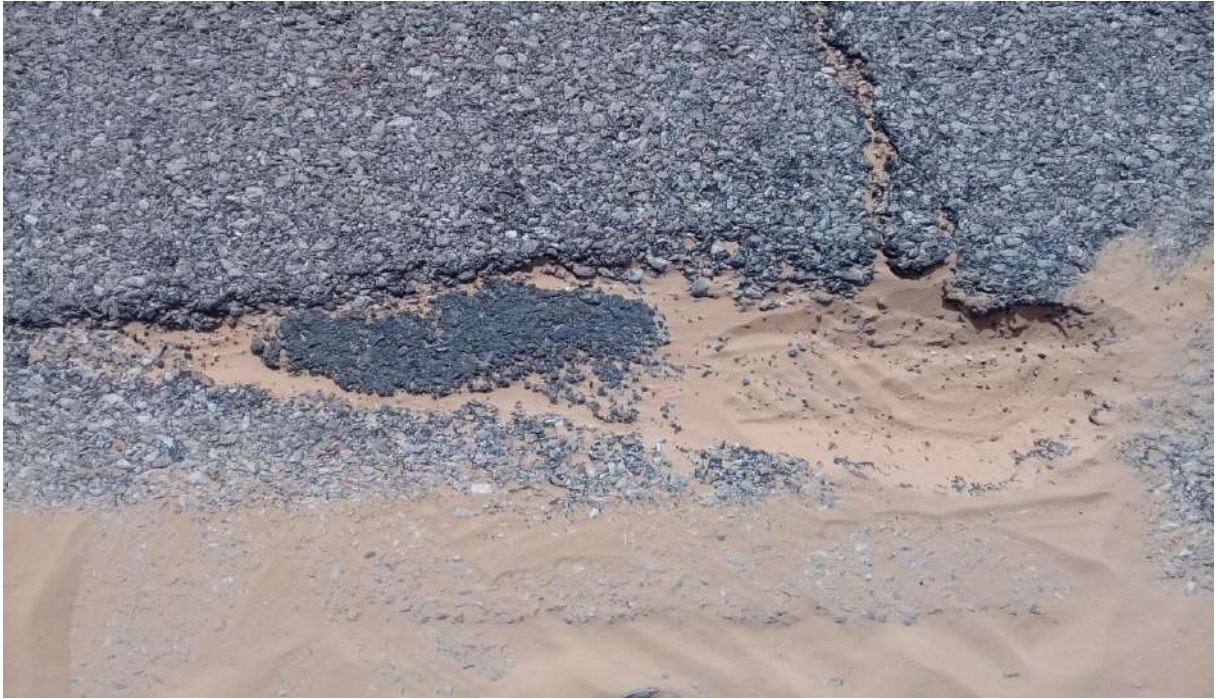
Figure 6 photographie des arrachements
