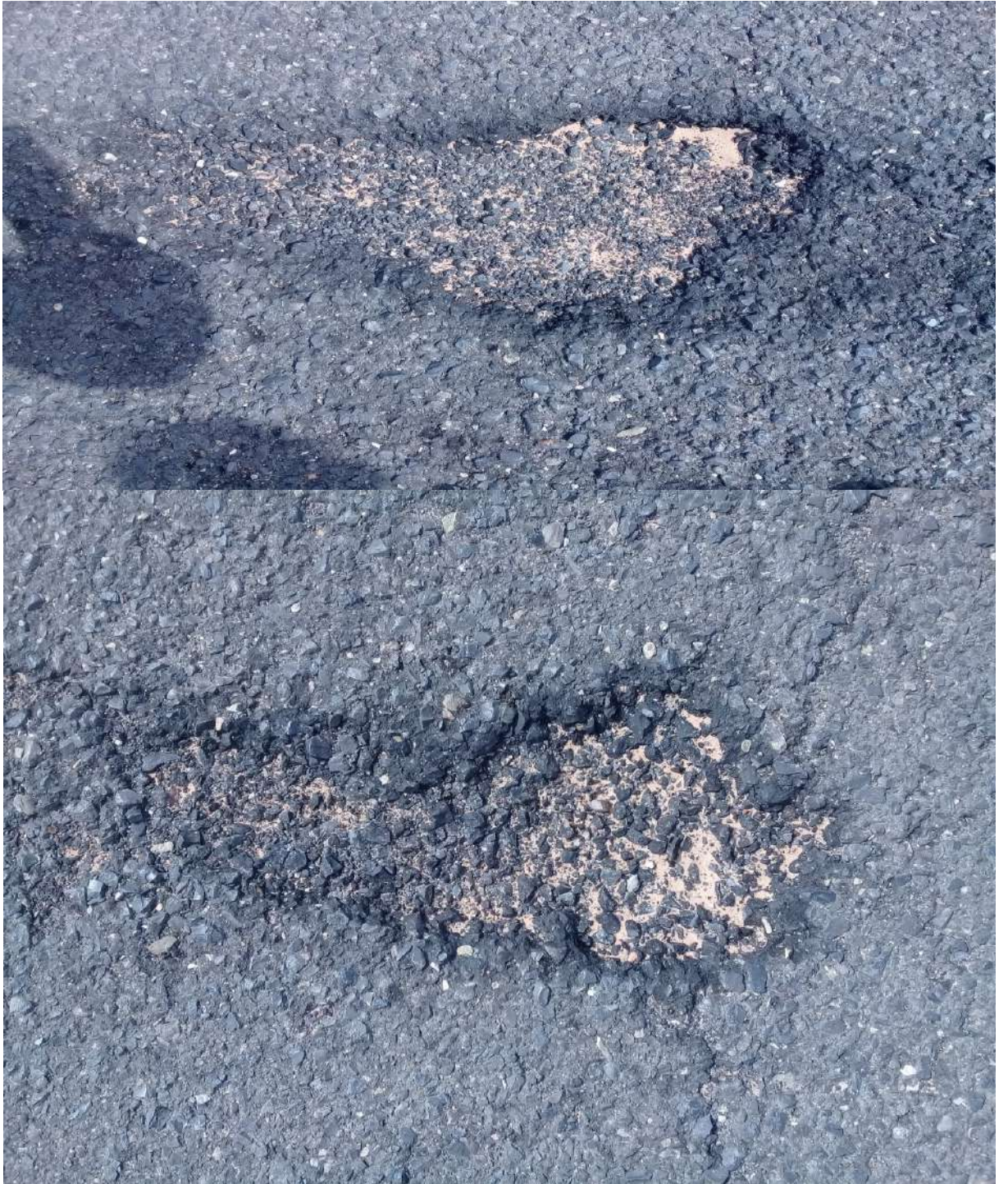
Figure 1 photographie de dégradation
