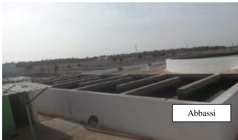
Photo.6 : Bassin de chloration.
