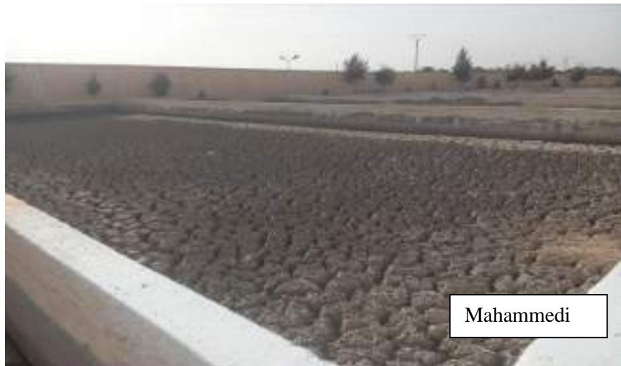
Photo.9 : lit de séchage.
