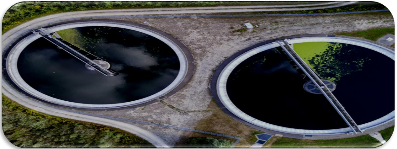
Figure I.7 : Traitement biologique des eaux usées industrielles [24].
