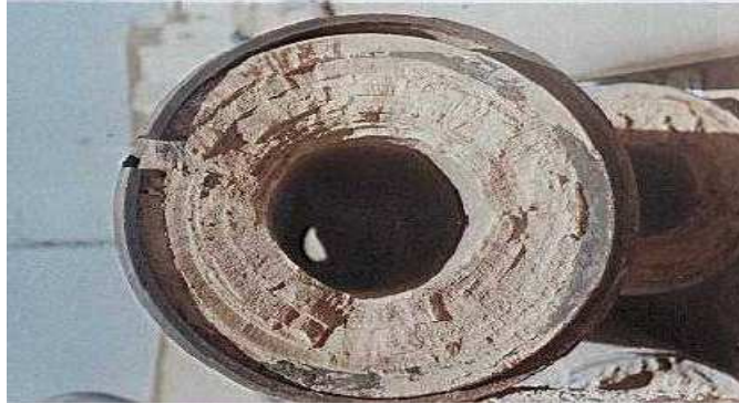
Figure N°7 : Entartrage des conduites de distribution en amiante ciment (BOUTAOUTOU et ZEGGANE, 2011)
