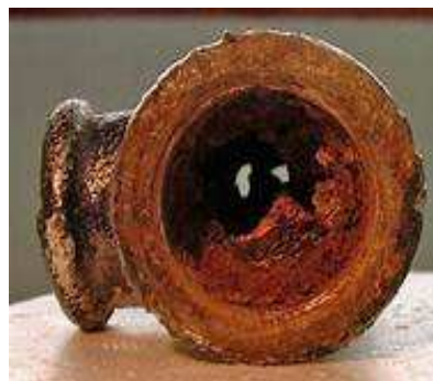
Figure N°11 : Type de corrosion galvanique (BERTOSSA, 2011)
