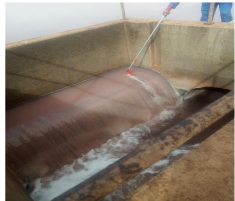
Eau traitée (Sortie)
