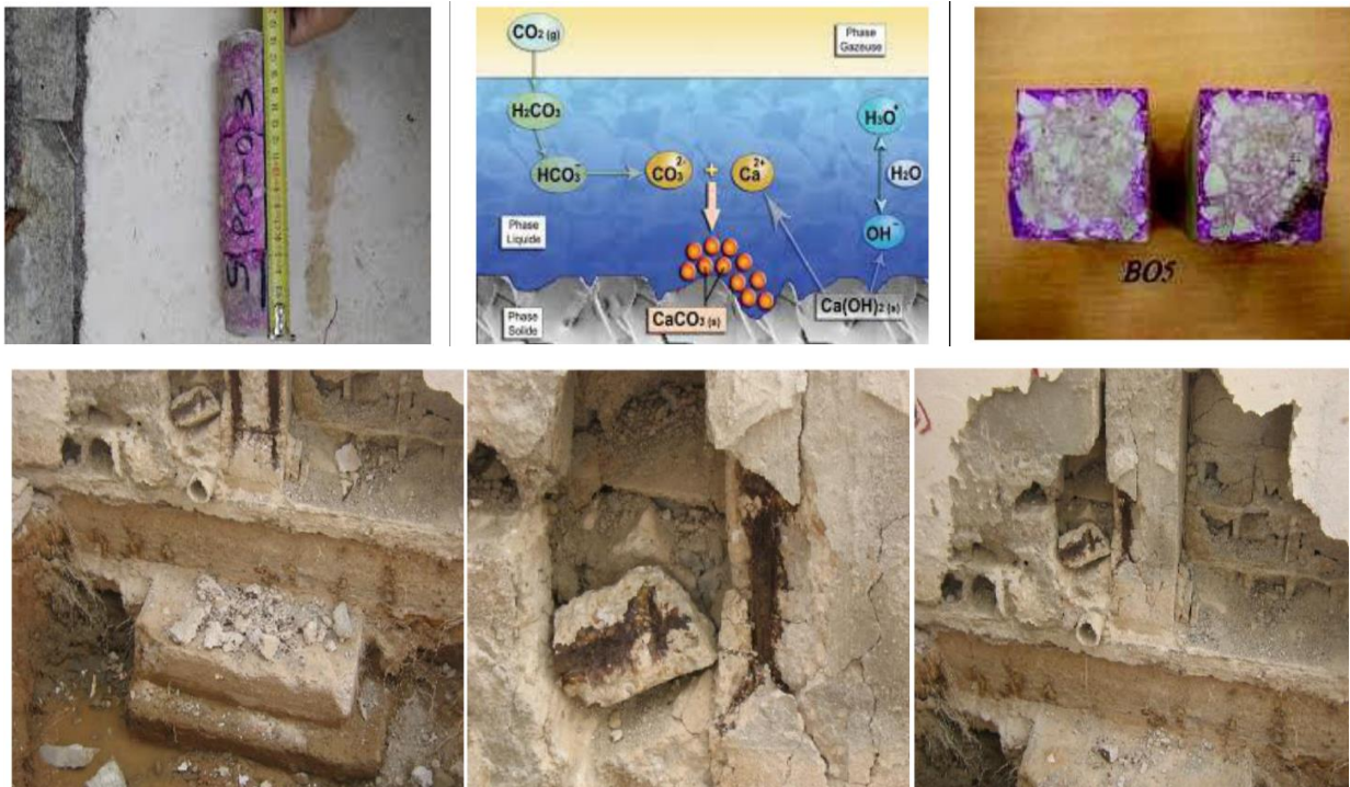
Figure (II.08) : Carbonatation du béton
