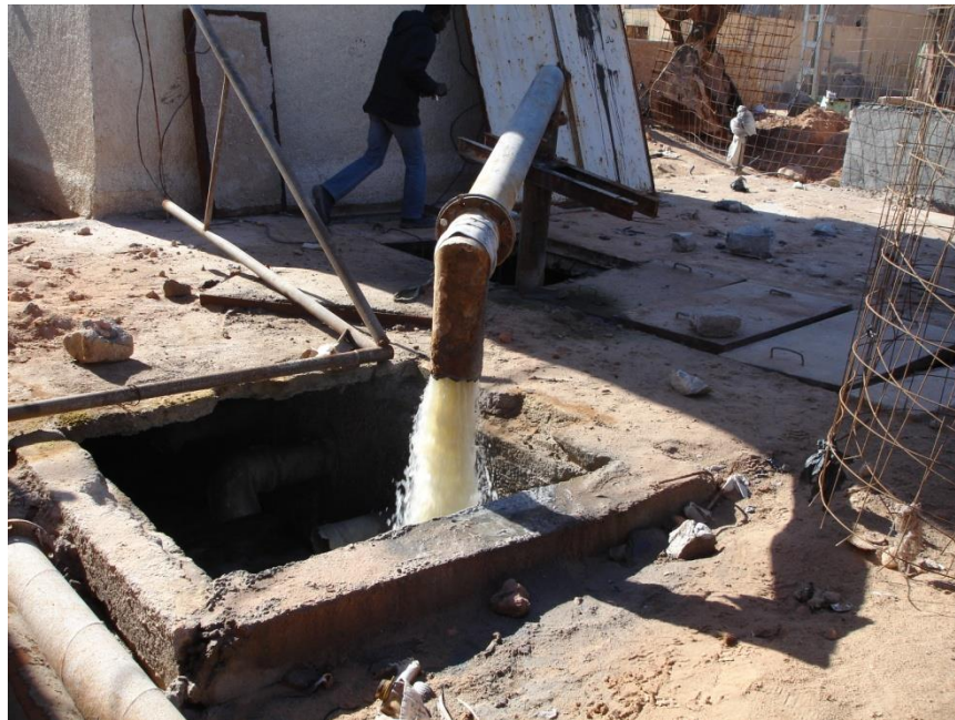
Figure (II.04) : Surélévation du niveau d'eau usée (Station de pompage Sokra)
