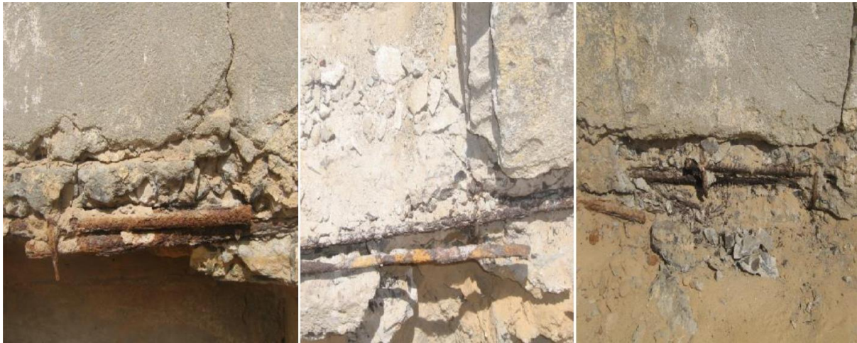
Figure (II.07): Armatures corrodés par l'effet de la remontée la de nappe.
