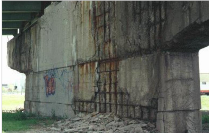
Figure I-2 : Agression du béton par activité des chlorures. [BOUALLEG,S.2004]
