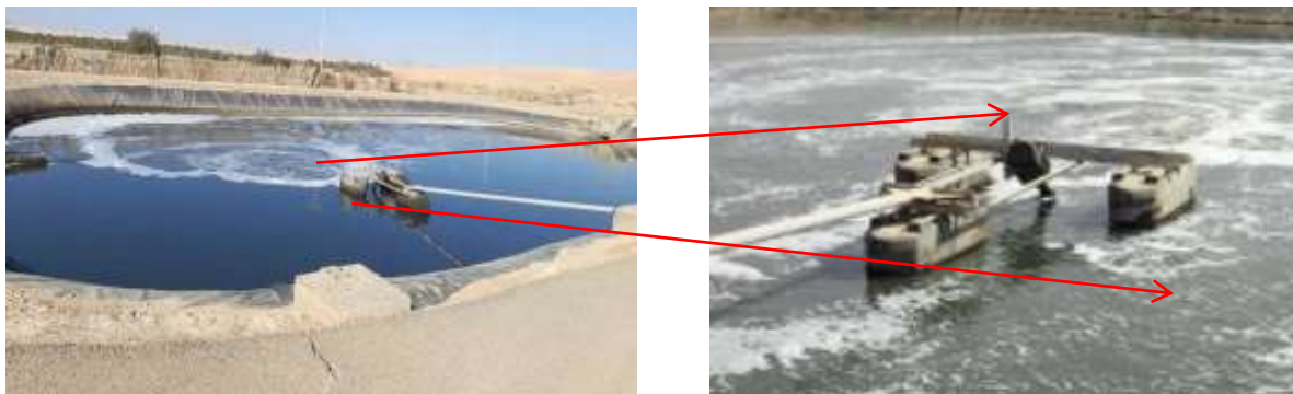
Photo N°08 : Bassin d'aération A (et Aérateur)
