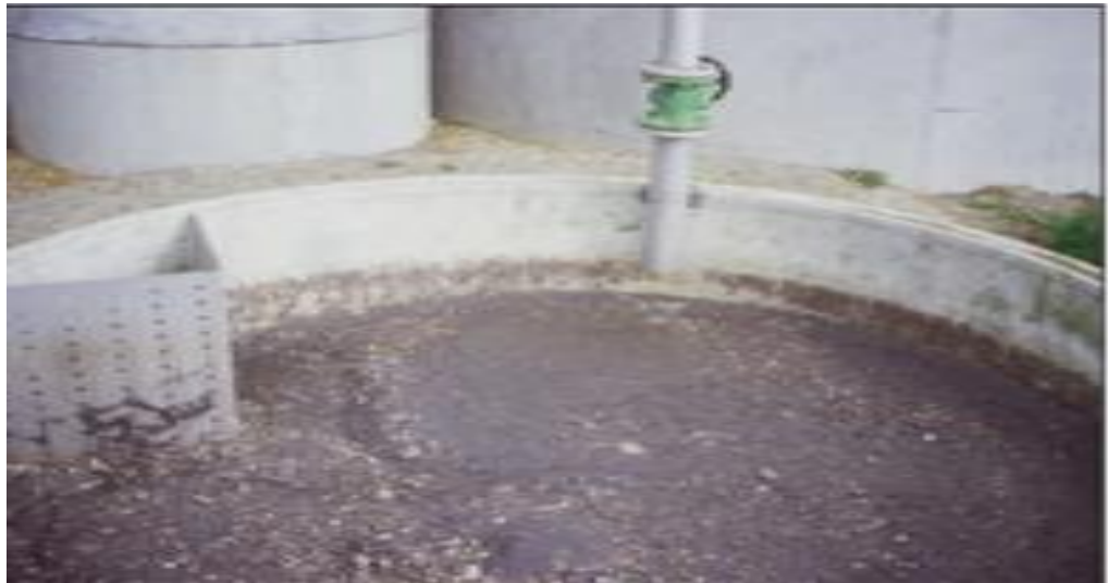
Photo 03 : Extraction du sable d'un sableur dégraisseur
