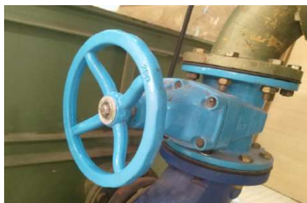
Figure 1.4: Vanne de régulation du débit.
