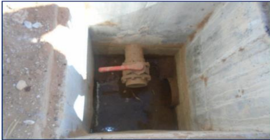
Figure III.15 Regard de rassemble l'eau traitée.
