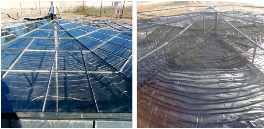
FIGURE III.5 – Une vue extérieure et intérieure du collecteur solaire
