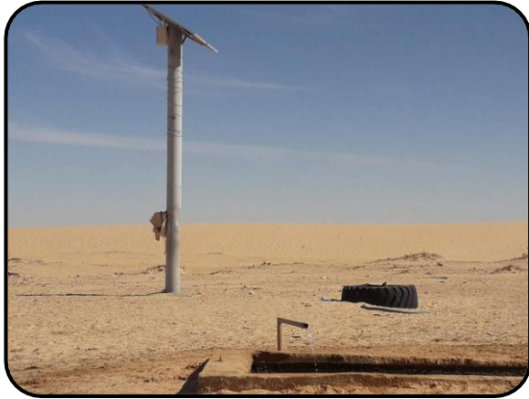
Photo 1 : Puits équipé par l'énergie solaire
