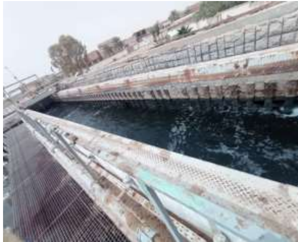
I.5.Photo: le déshuilage et dessablage (photographie original)
