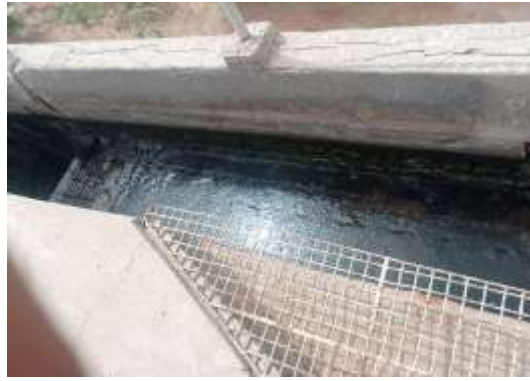
I.4.Photo: Le dégrillage (photographie original)
