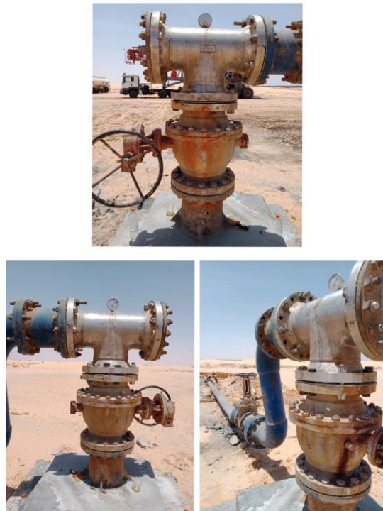
Figure. III.16 : tête de puits (sidi mahdi).
