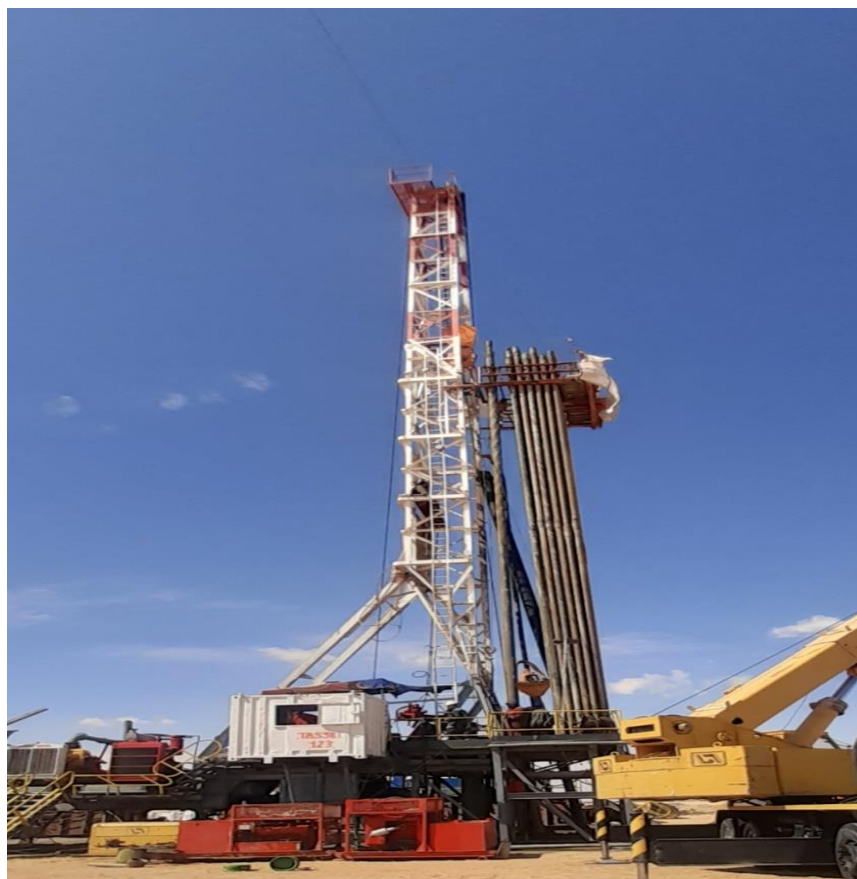
Figure N° 03 : Le mât de forage.
