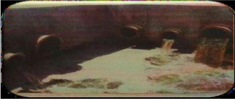
Figure ( III.03): Entrée des eaux usées à la station (bassin de dégazage)
