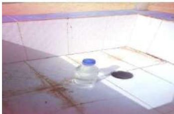
Figure (III.36): Bassin de l'eau traitée
