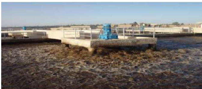
Figure (III.22) : Bassin d'aération dans la station de Touggourt
