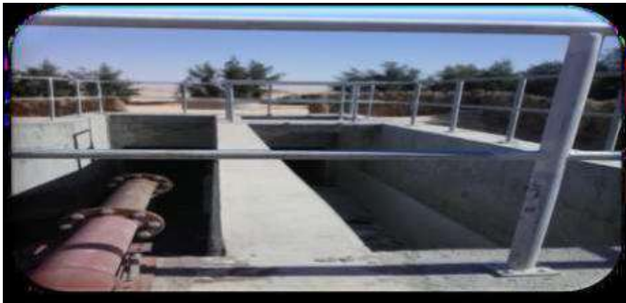
Figure ( III.07): Canales de transport des eaux usées (à gauche) et des eaux de drainage (à droite) Dans la station d'Ouargla [43]
