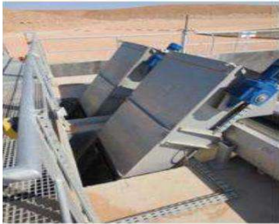
Figure (III.11): Dispositif de criblage mécanique
