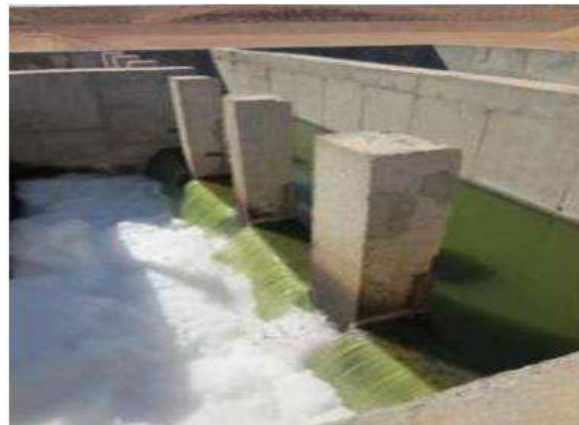
Figure (III.14): Sortie d'eau des bassins de sédimentation
