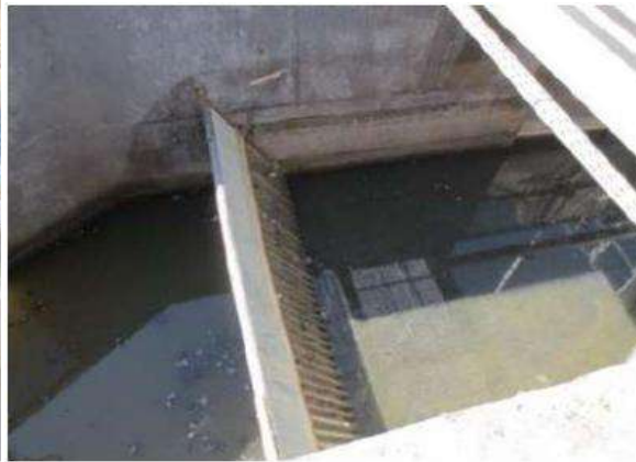
Figure (III.12): Réseau fixe dans le canal de dérivation
