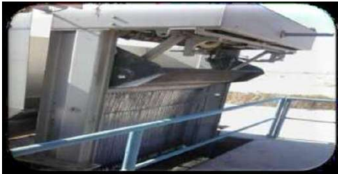
Figure ( III.04) : Dégrilleur dans la station d'Ouargla
