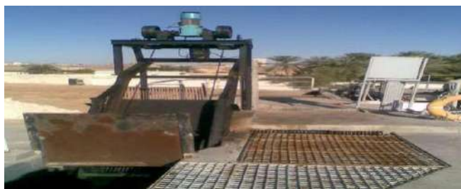
Figure (III.20): Dégrillage dans la station de Touggourt
