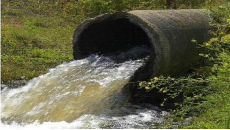
الشكل (1.II): صورة توضح مياه الصرف الصحي
