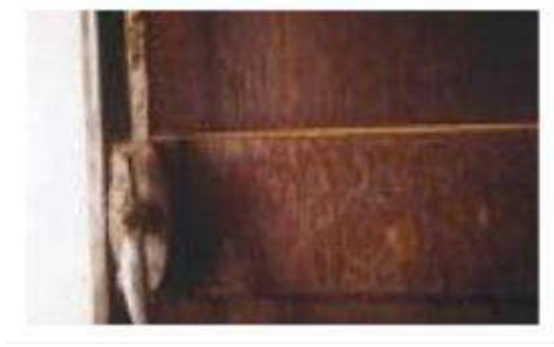
الشكل (1.1): التآكل المنتظم (العام).
