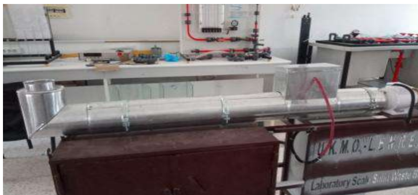
Figure 5 : Conduit d'air isolé thermiquement.
