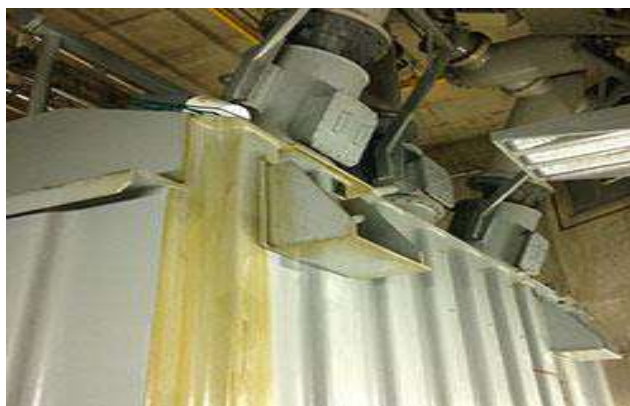
Figure I.9 Fuite d'huile de transformateur [7].
