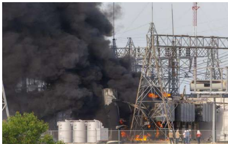
Figure.I.8 Explosion du transformateur de puissance centrale de la sous-station de central électrique[15]
