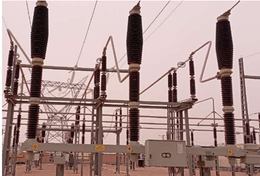
Figure I.4 Transformateurs de mesure TT et TC-GRTE 220 Kv.
