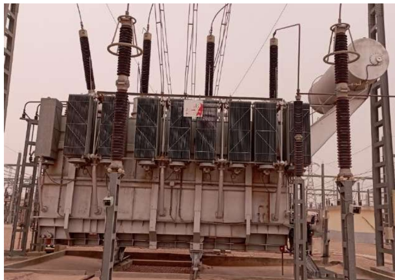
Figure I.2 Transformateur de puissance GRTE 220Kv/60Kv.
