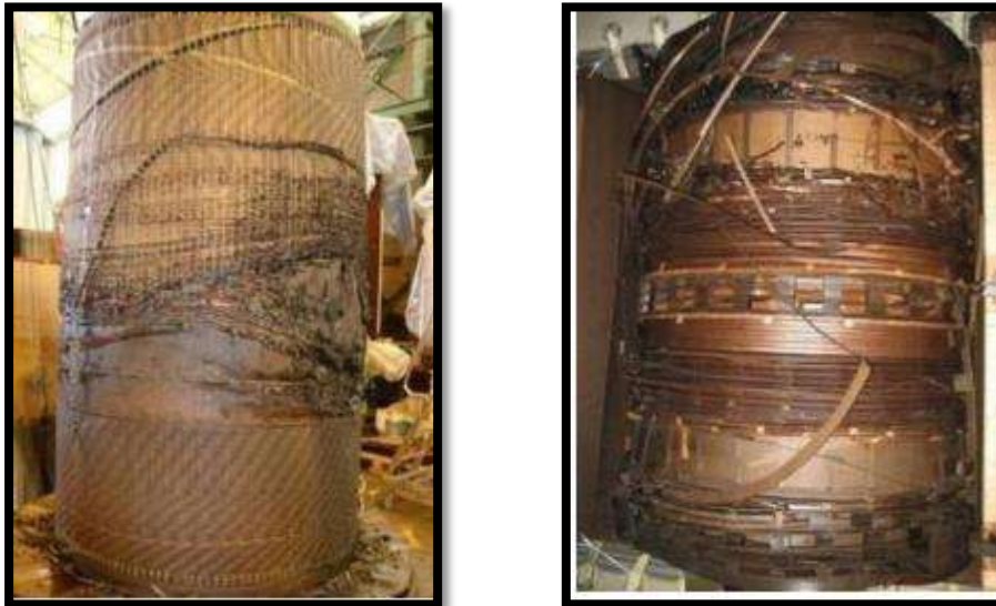
Figure I.12 Exemple de défaut de base endommagé dans un transformateur de puissance [5].
