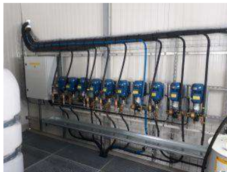
Photo 1.9 : Pompes et doseurs à adjuvants.
