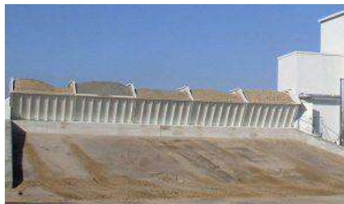
Photo 1.2 : Trémies à granulats.
