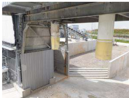
Photo 1.12 : Postes de chargement des camions toupies.
