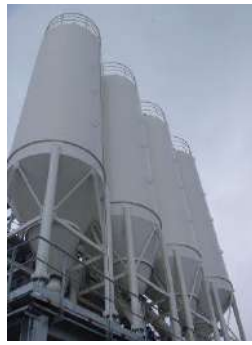
Photo 1.3 : Silos à liants.
