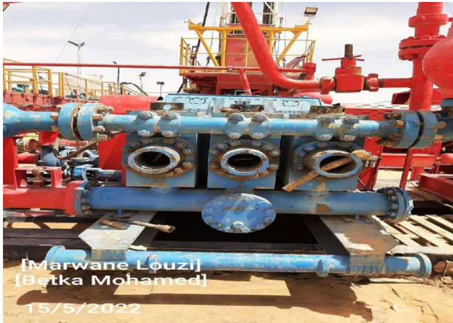
Figure N°24 :La pompe à boue
