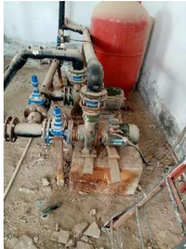
Figure II.7 : station pompage d'eau
