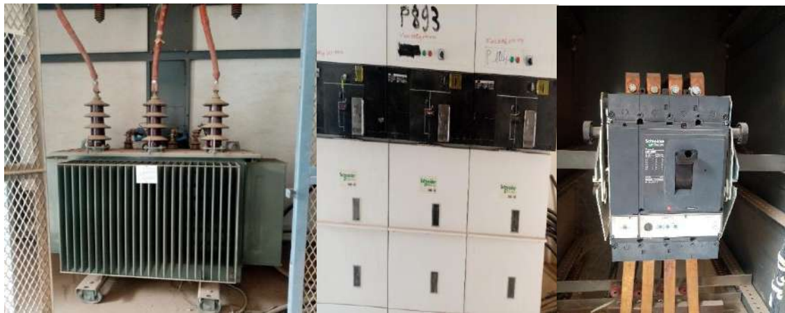
Figure II.9 : Transformateur de site
