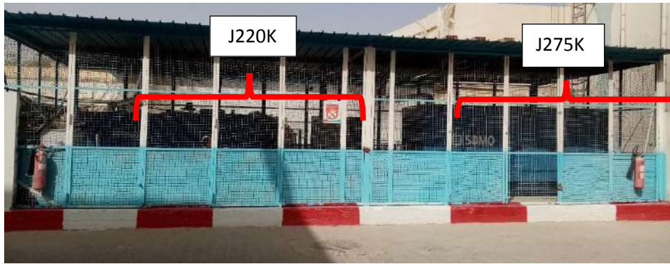
Figure II.1 : Les groupes électrogènes de L'Hôpital
