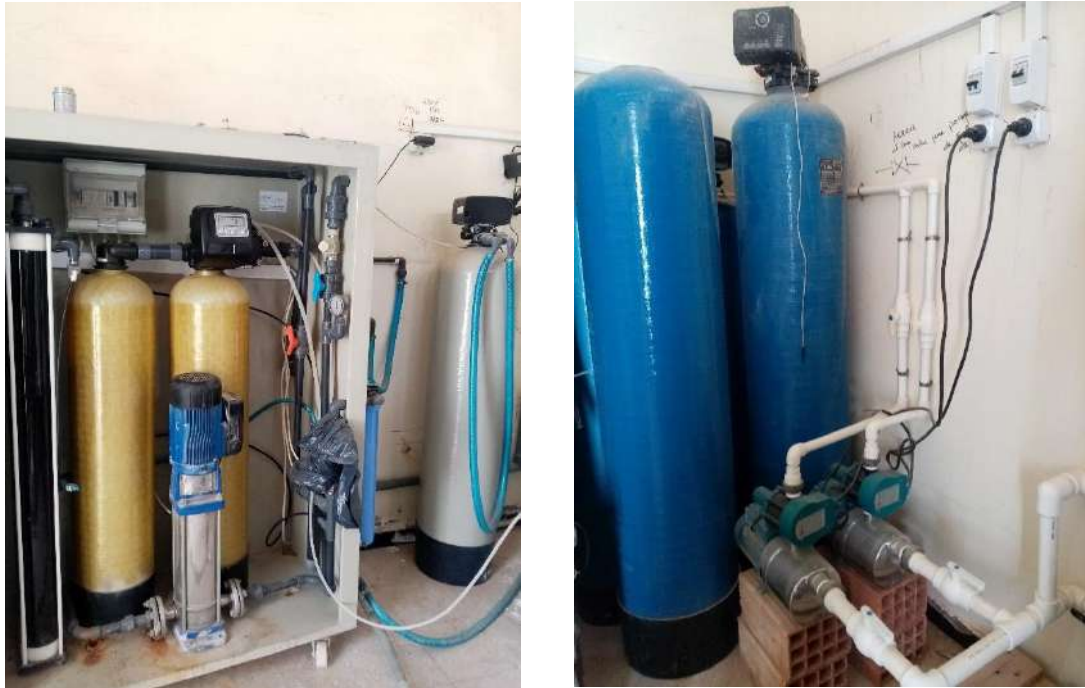
Figure II.6 : station traitement d'eau d'hémodialyse
