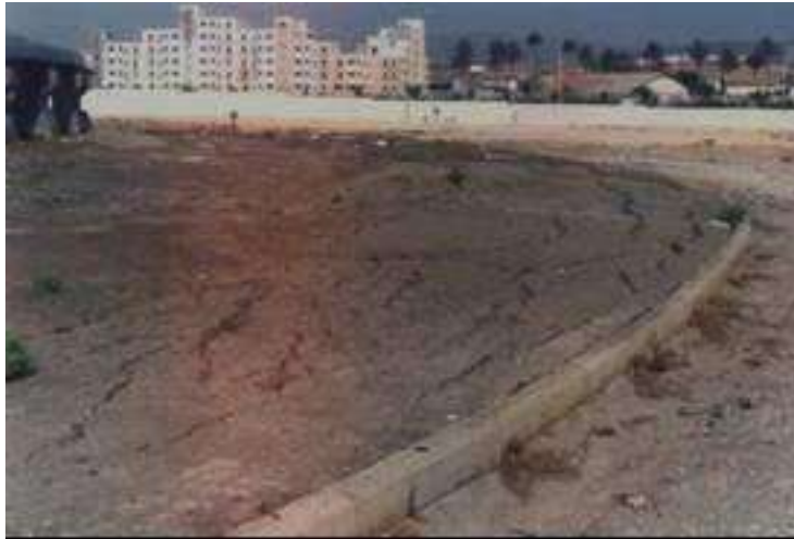
Figure II-5 des fissures au tour du bac
