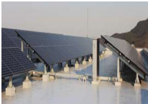
(a) Installation PV sur un toit
