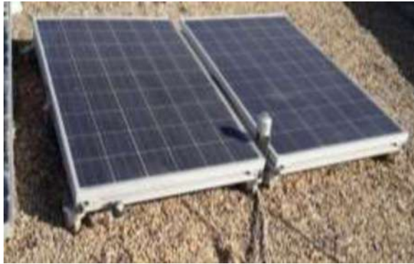
Figure 6. 8 Echantillon de panneau PV choisi
