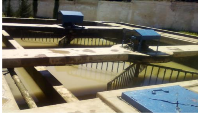
Figure III-07 : Les bassins de flocculation
