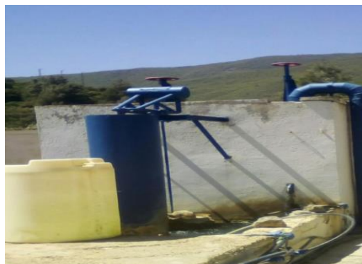
Figure III-06 : La chambre d'équilibre et la vanne cylindrique
