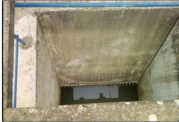
Figure III-03 : Dégrilleur moyenne à l'entrée de la station
