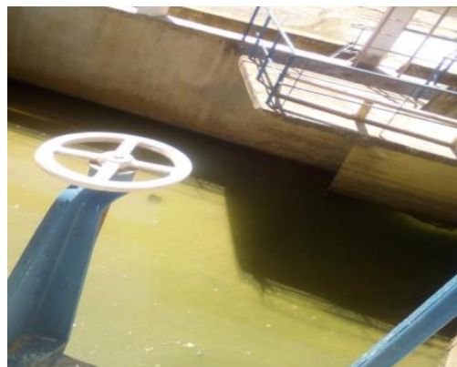
Figure III-04 : Chambre de relevage
