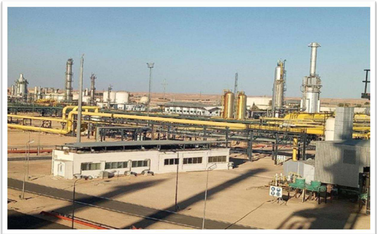
Figure II.4: Vue d'ensemble de l'unité GPL-2.
