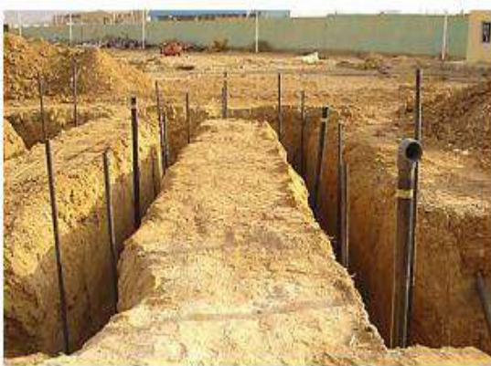
Figure. II.10. Emplacement des capteurs le long de l'échangeur de chaleur
