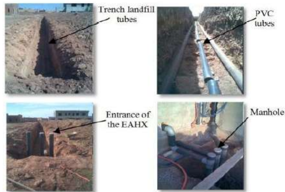
Figure. II.9. Photos de l'installation de l'EAHX
