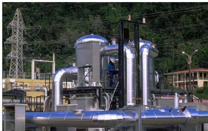
Figure. I. 6. Une centrale géothermique
