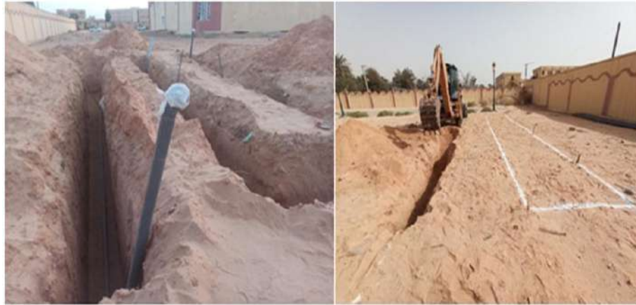
Figure. III. 1 . Vue général de l'échangeur d'air/ sol
