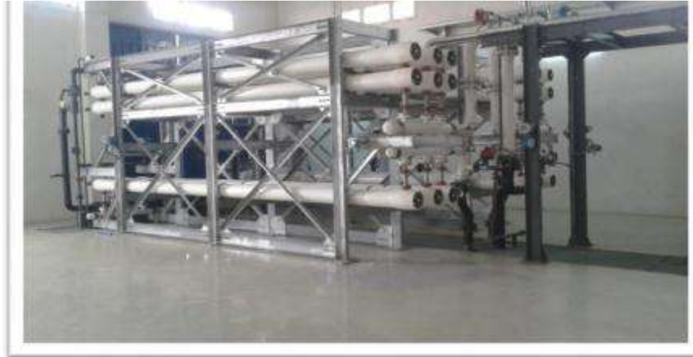
Photo (01):Unité d'osmose inverse
