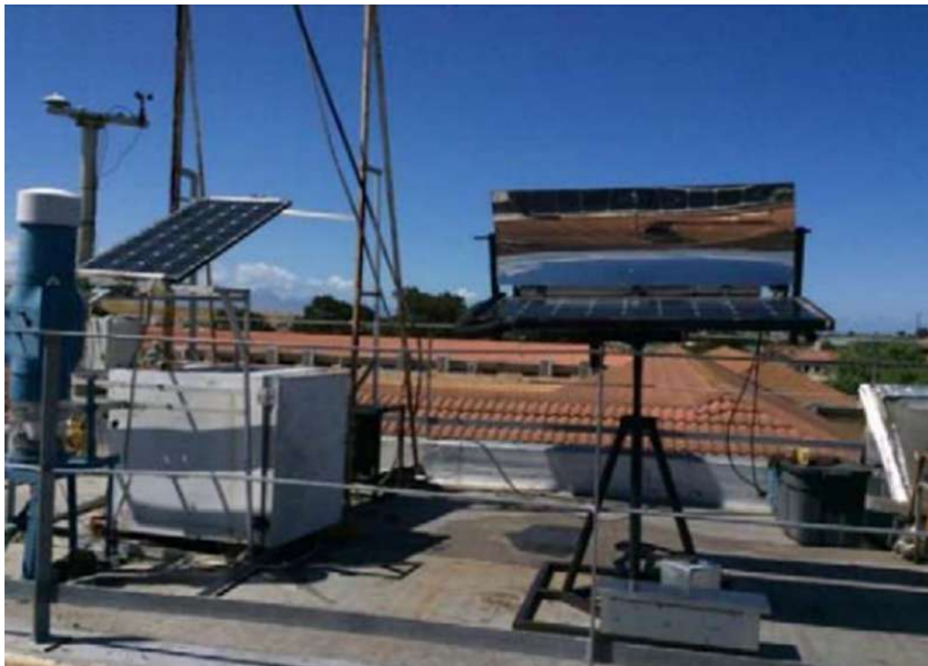
Figure I.35. Vue générale du système complet [51]
