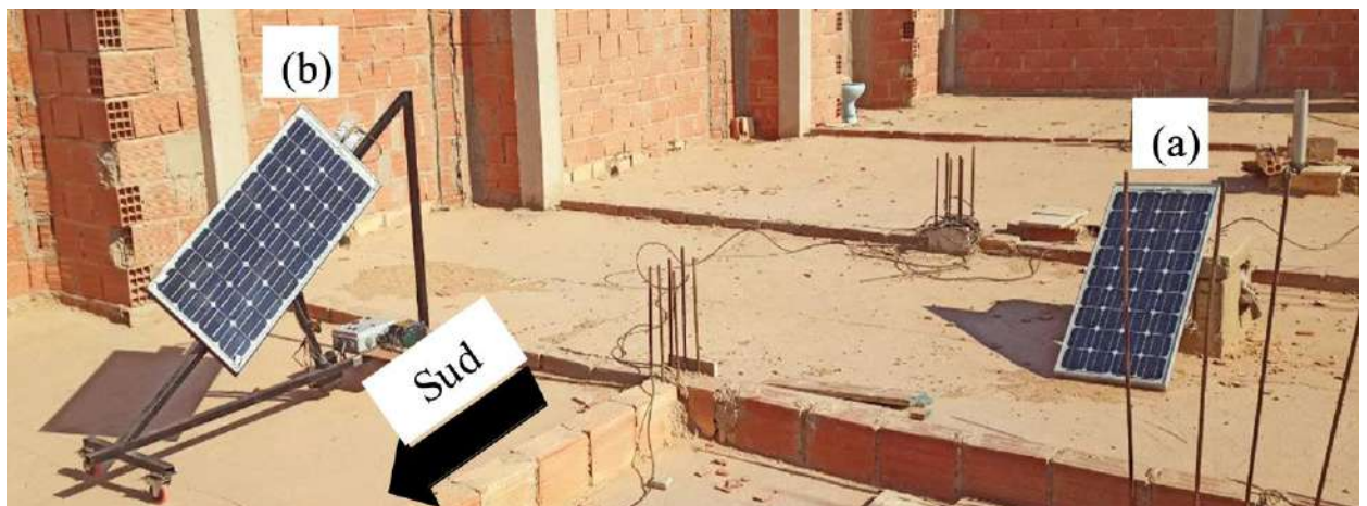
Figure III.3. Installation de la journée du 23/05/2022 : (a) panneau solaire PV fixe (témoin), (b) panneau solaire mobile (sur un traqueur à axe polaire)
