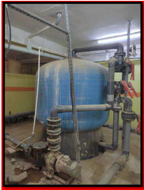
Figure II. 7:Le filtre à sable dans la chambre de maintenance
