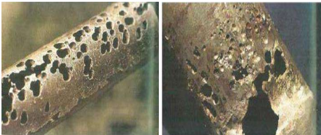
Figure I.8 : Exemple de corrosion bactérienne.
