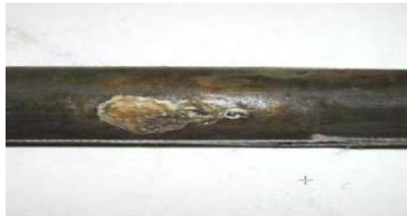
Figure I.9 : Exemple de corrosion externe
